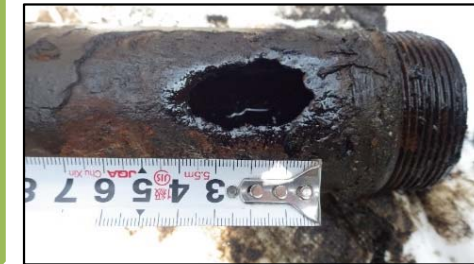
【腐食した埋設配管】
